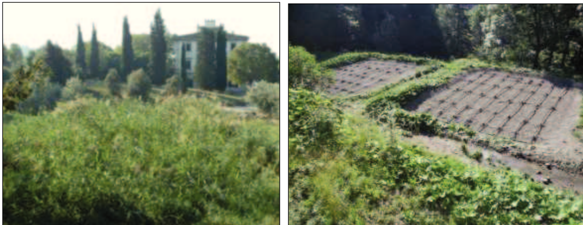
Figura 11 – A sinistra: sistema di fitodepurazione a servizio dell'Hotel Relais Certosa (FI), a destra: impianto a servizio del rifugio Abetina Reale (RE)
