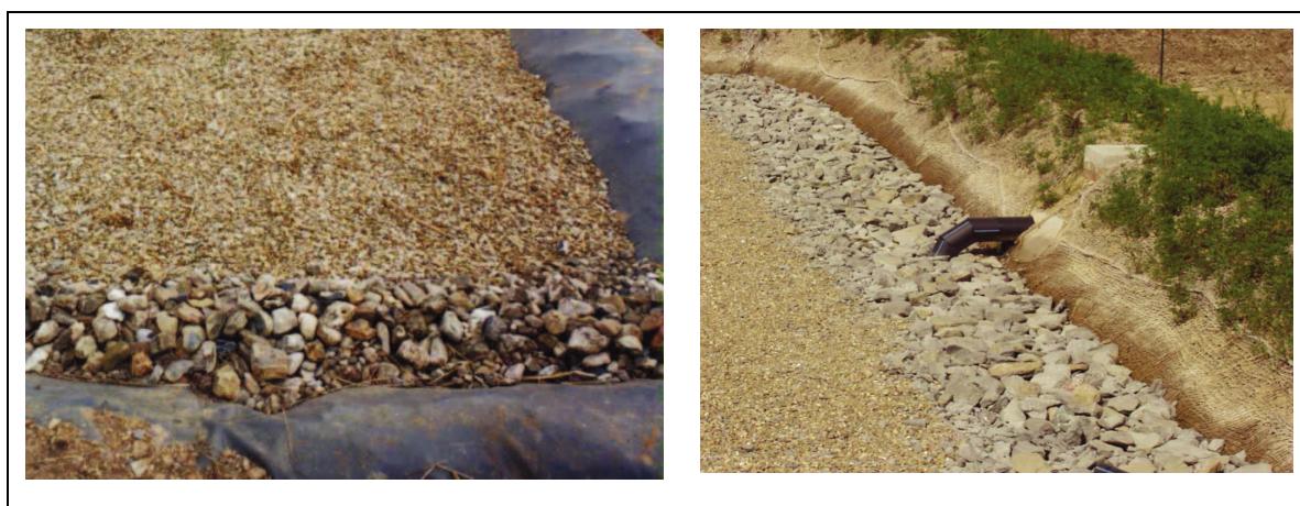
Figura 3.15 –Sistemi di fitodepurazione a flusso orizzontale: particolari dell’area d’ingresso con pietrisco per la corretta distribuzione del refluo
