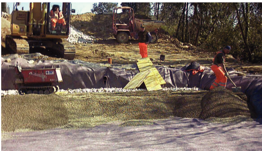
Figura 3.12 – Disposizione del medium di riempimento.
